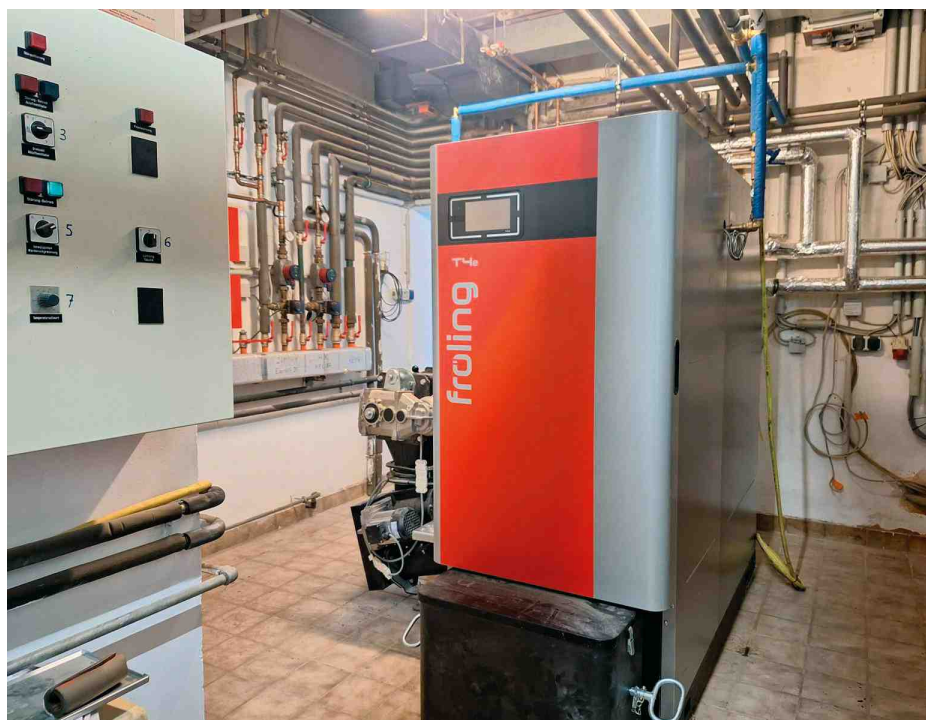
Das Eventhotel Neuhof in Neuhofen an der Ybbs wird seit heuer mit der neuen Fröling Hackgutheizung T4e mit 180 kW beheizt.
