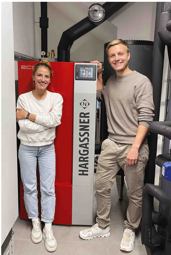
Juliana und Daniel Döllerer mit ihrem Eco PK 100 Pelletheizkessel im Heizraum des apollo am Mondsee.
