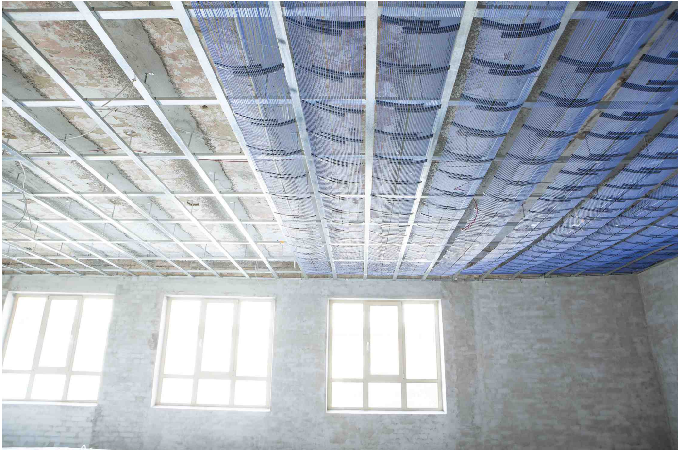
Kühldecken gibt es in vielen Formen. Sie können modular in Elementen abgehängter Decken montiert werden, oberhalb von Gipskarton oder auch als Rohrschlangen oder Kapillarrohrmatten in Beton oder Putz verlegt sein. Bild: geoCLIMAdesign/BWP
