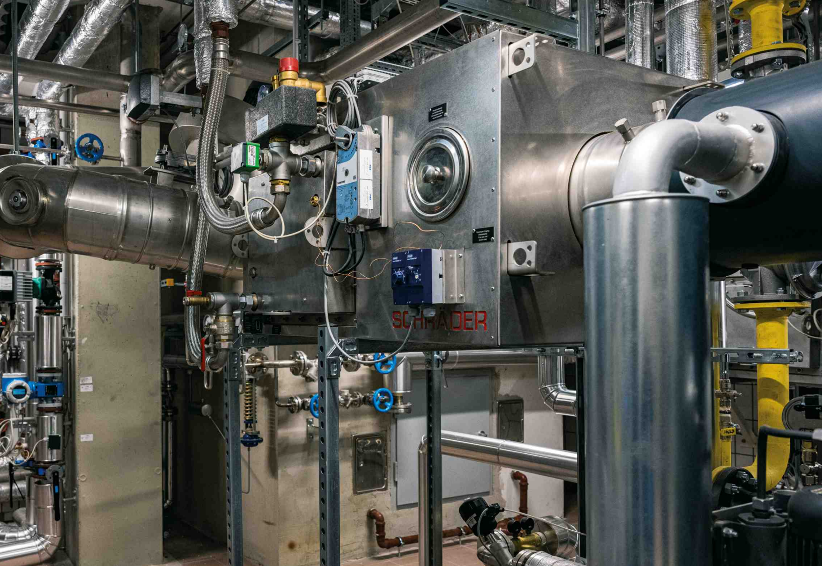
Herzstück des neuen Wärmekonzepts: Der Schräeder Abgaswärmetauscher mit integriertem Bypass für den Dampfkessel CERTUSS 850.
