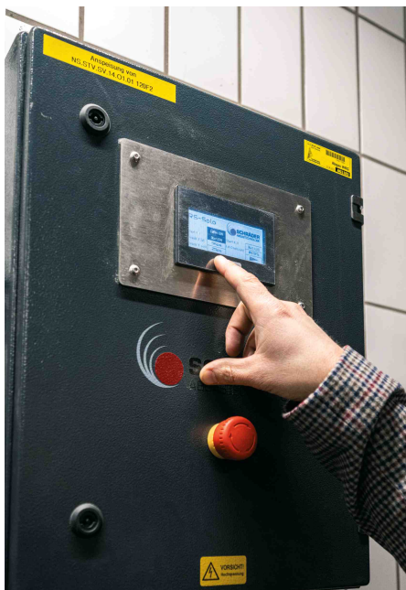
Die Schröder-Rauchsauger-Regelung passt die die Drehzahl des Ventilators an.
