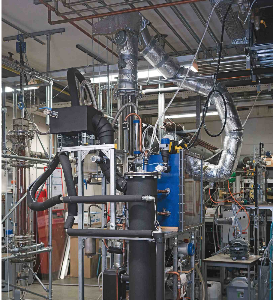
Das Rohrbündel überträgt die Wärme für die anschließende Brennwertnutzung.
