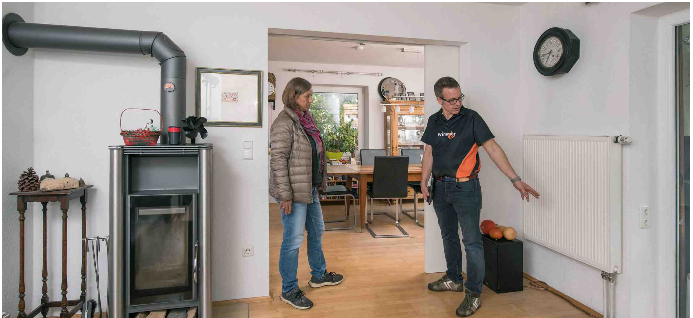
Die Heizleistung von Radiatoren bietet in der Regel genügend Reserven, um auch bei einer geringeren Vorlauftemperatur noch genügend Wärme zu erzeugen.
