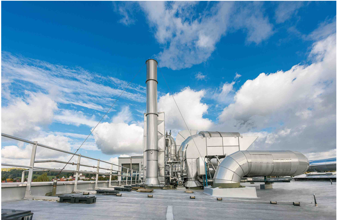
50 db(A) weniger Schall: Die Vakuumbelüftung-Anlage auf dem Dach der Papierfabrik erhielt die umfangreichste Lärmsanierung.
