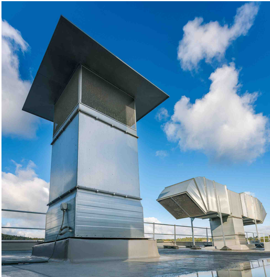
Neukonstruktion: Schalldämpfer und Gehäuse der Zuluftanlage für den Brennerraum wurden auf dem Dach neu angelegt.
