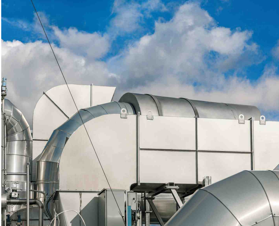
Feuchte, heiße, staubhaltige Luft war auch bei der Nebelabsauganlage Programm. Auch hier wurde auf eine Ausführung in Edelstahl gesetzt.
