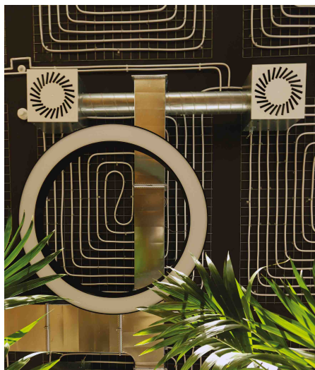
Die sichtbare Industriedeckenaktivierung kann durchaus ansprechend sein.
